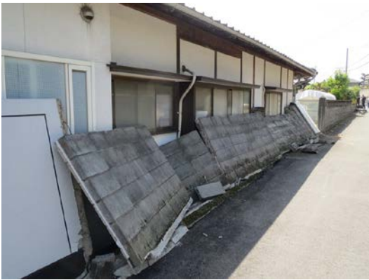
家は無事でもブロック塀の多くは転倒していた。
