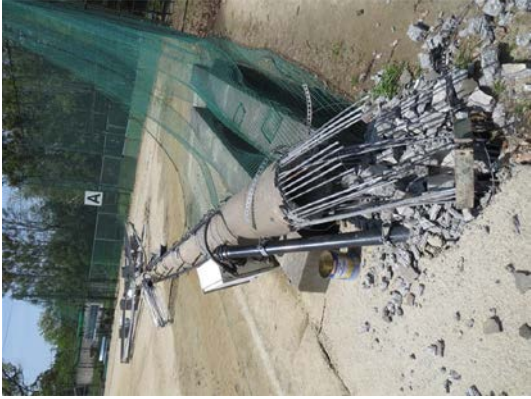
グラウンド照明施設も根元から折れていた
