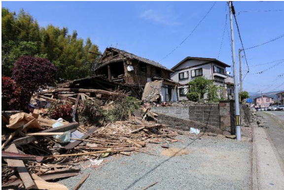
旧耐震と新耐震の建物被害の相違
