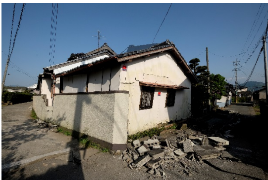
南北方向のブロック塀の倒壊が多い
