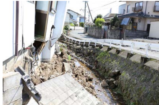
水路の石積み崩落し、住宅の基礎と道路の陥没を引き起こしている。
