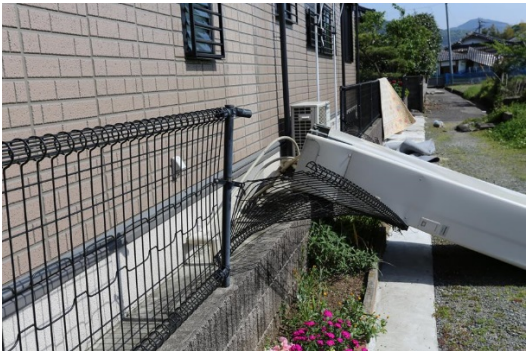
震源近くの家が多くで、エアコンの室外機や給湯施設の転倒が見られた。
