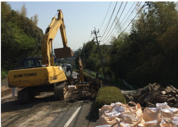
益城町寺迫 国道 443 号 陥没区間
