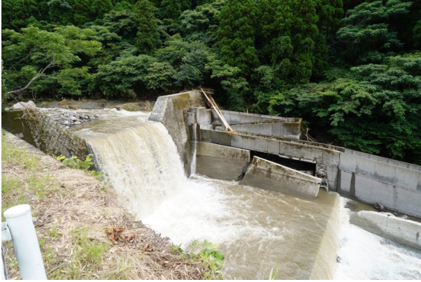
図4 魚道の破損状況.
