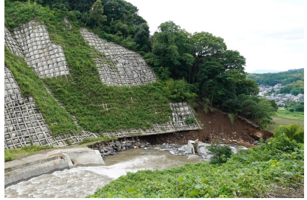
図5 洗掘により法面保護工の下部が浮いている.
