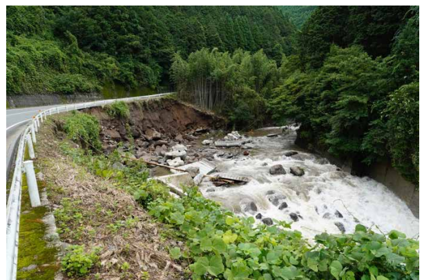
図3 破壊された護岸。
