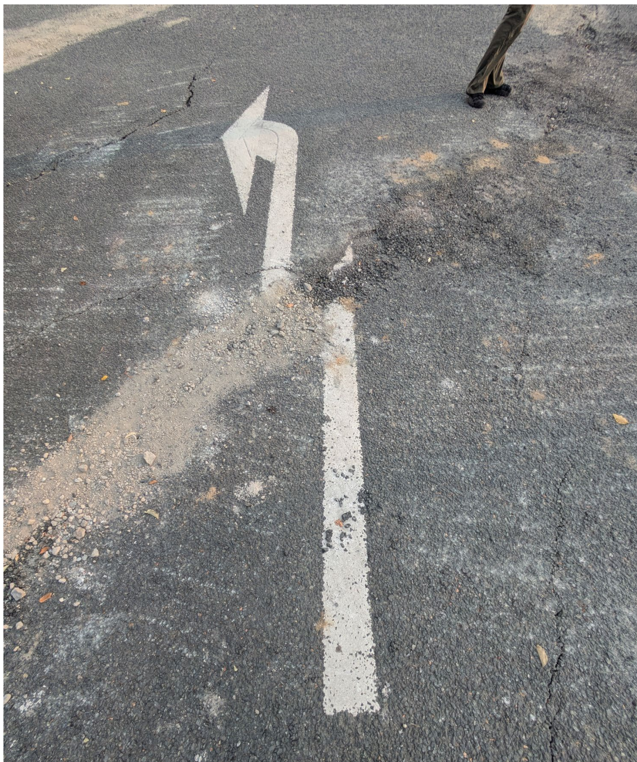
道の駅竜北に生じた地表地震断層におけるせん断変位（写真中の矢印のズレ）
