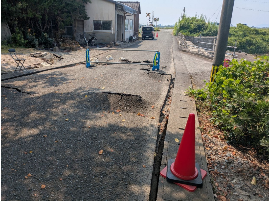
球磨側河川敷近くに生じた地表地震断層
