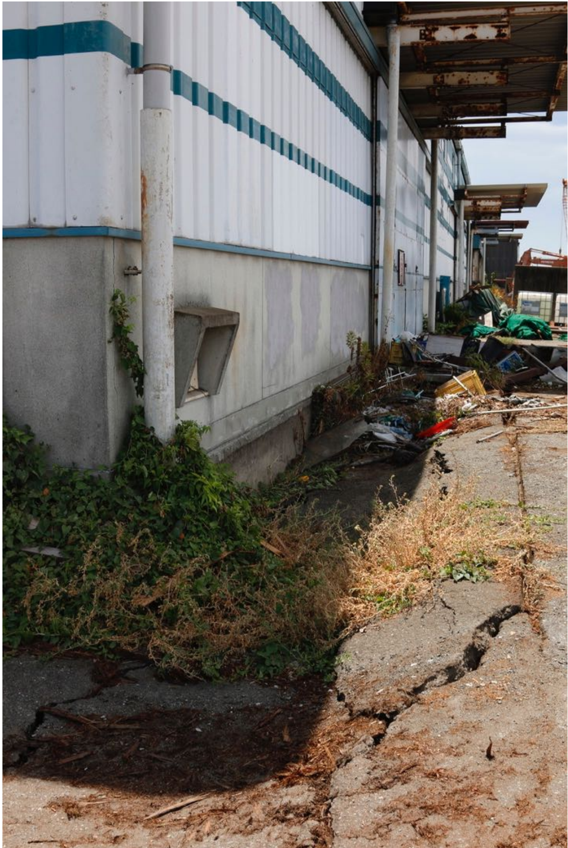
写真 1 7. 港の建物周辺の地盤が沈下した。
