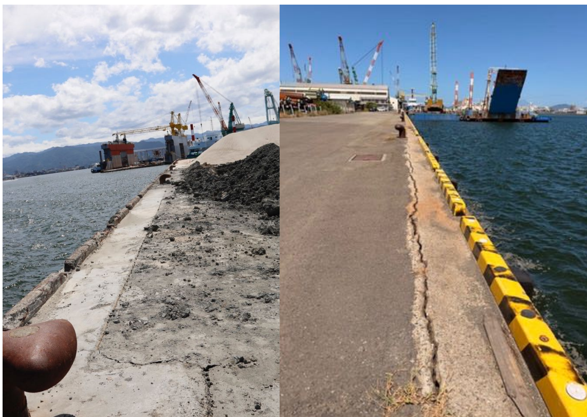
写真 1. 岸壁の側壁コンクリートにひび割れが発生した.
