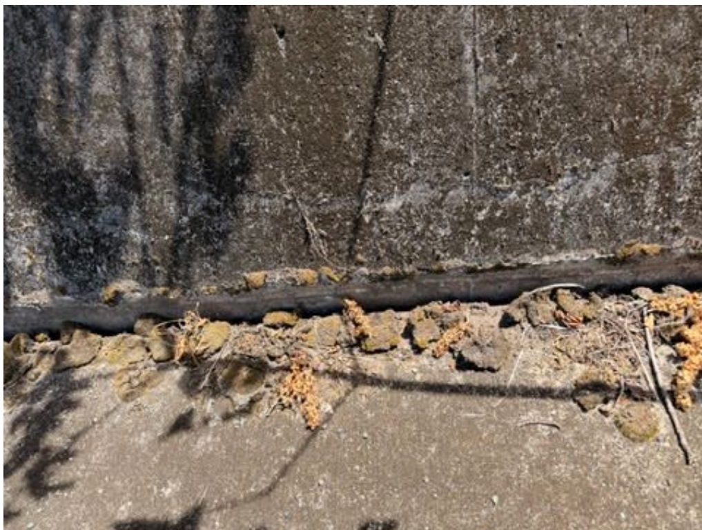
写真 2 0. 堤防に変形が発生した。
