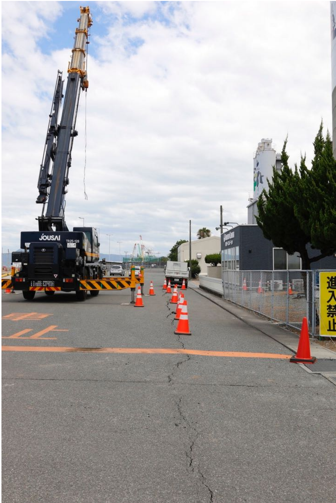
写真9. 港の作業場にひび割れが発生した.
