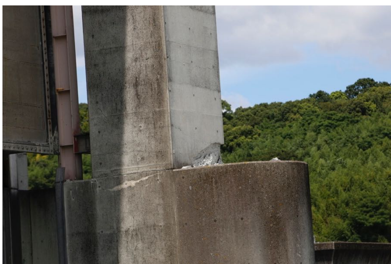
写真 2 3. 水門の地盤と柱にひび割れと変形が発生した。
