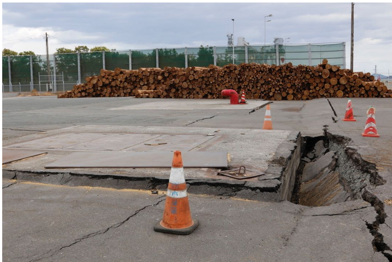
写真 1 0. 港の作業場に隆起・沈下が発生した.
