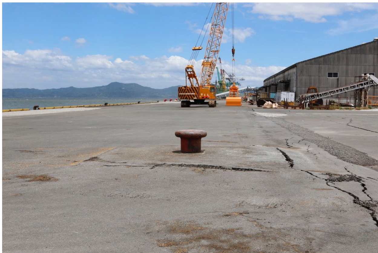
写真 1 5. 港の作業場にひび割れが発生した。
