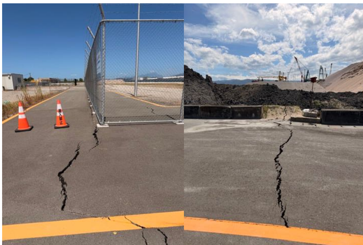
写真 2. 道路にひび割れや隆起が発生した.
