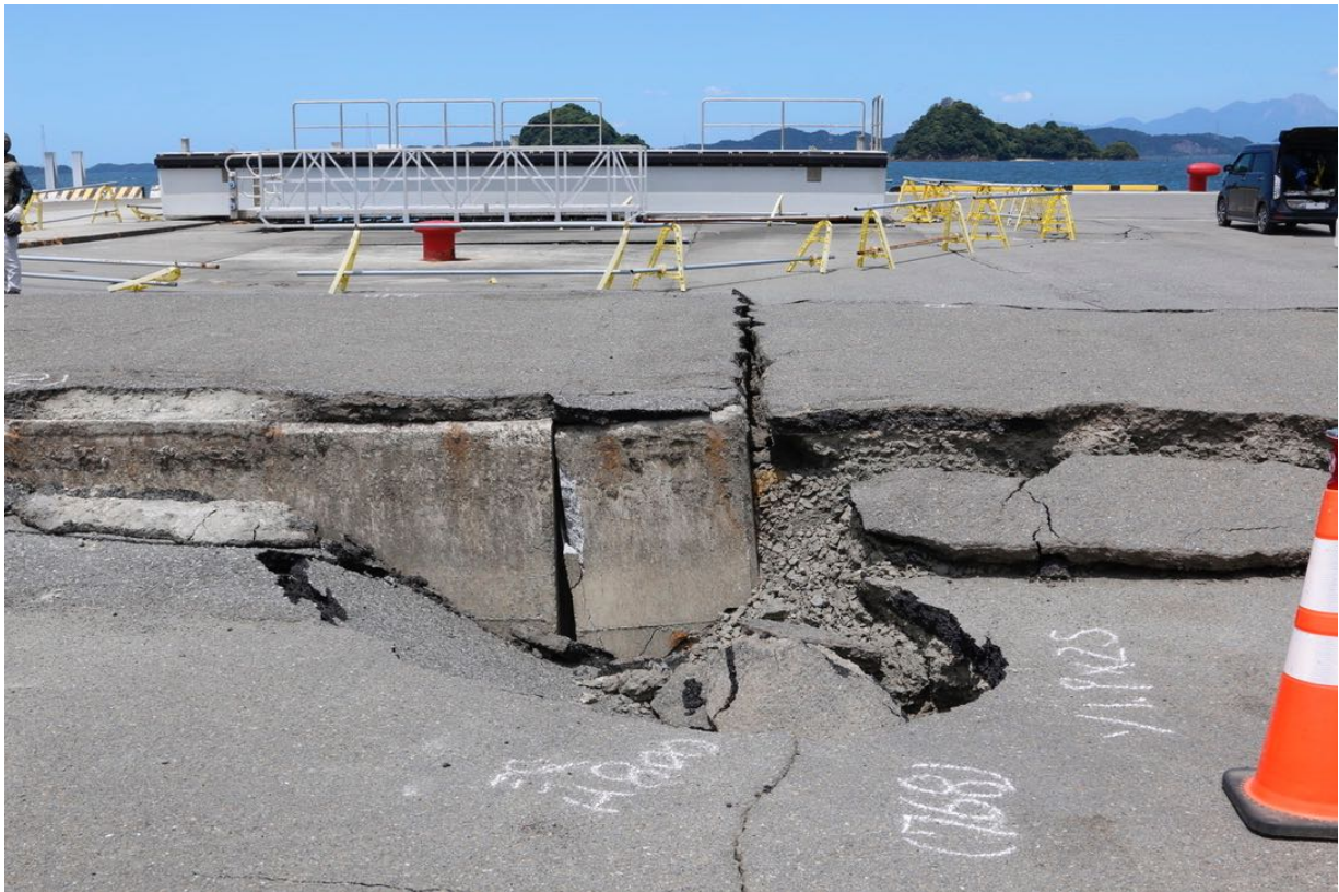
写真4. 港の地盤に隆起・沈下が発生した.
