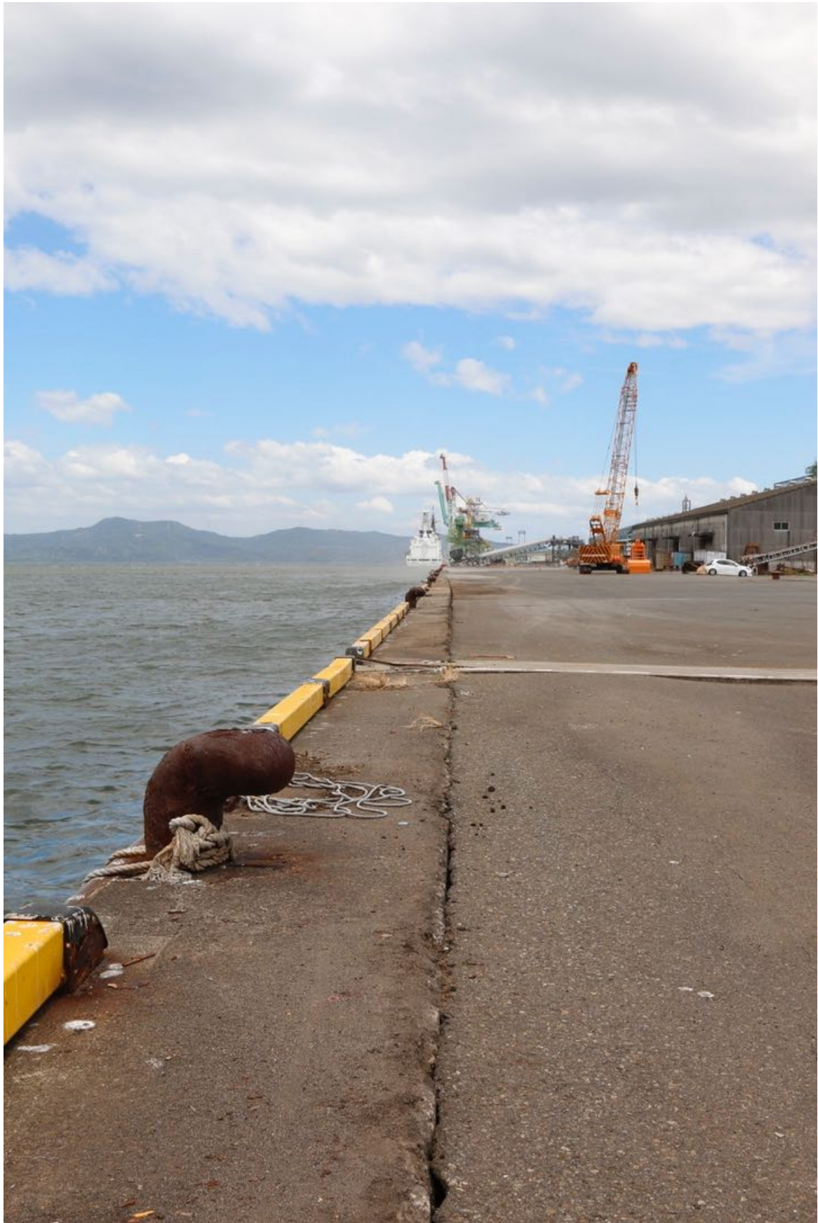
写真 1 4. 港の岩壁側にひび割れが発生した。
