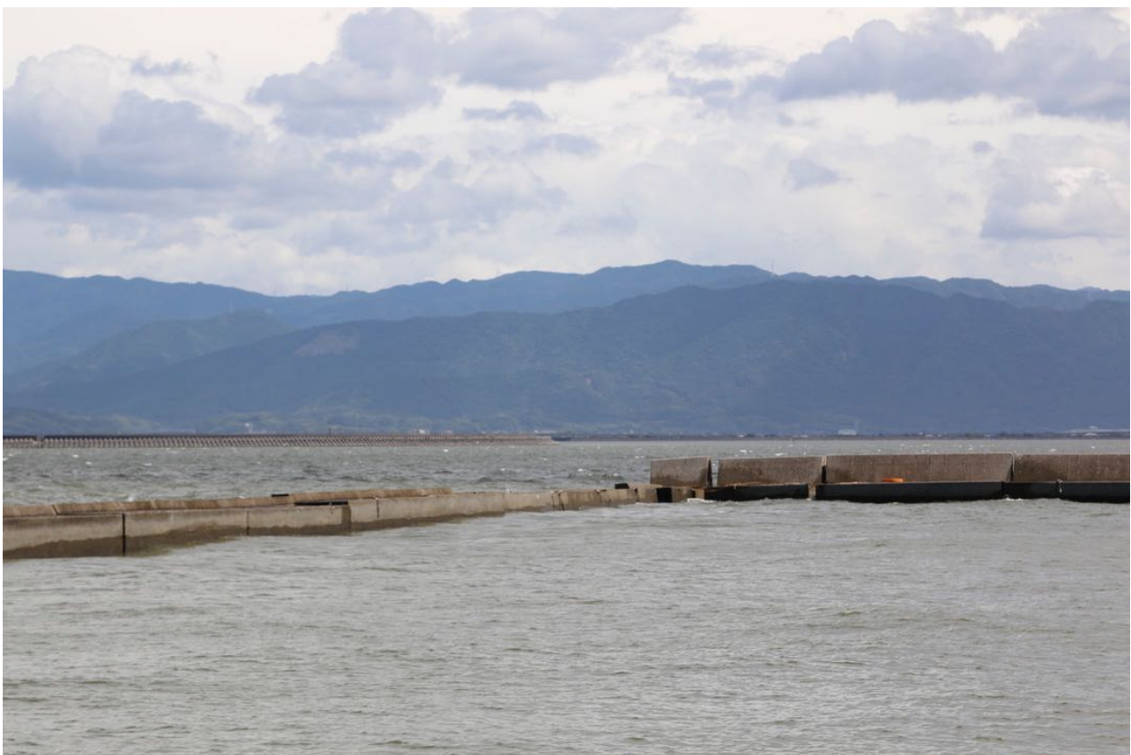
写真 2 5. 堤防に沈下と変形が発生した。
