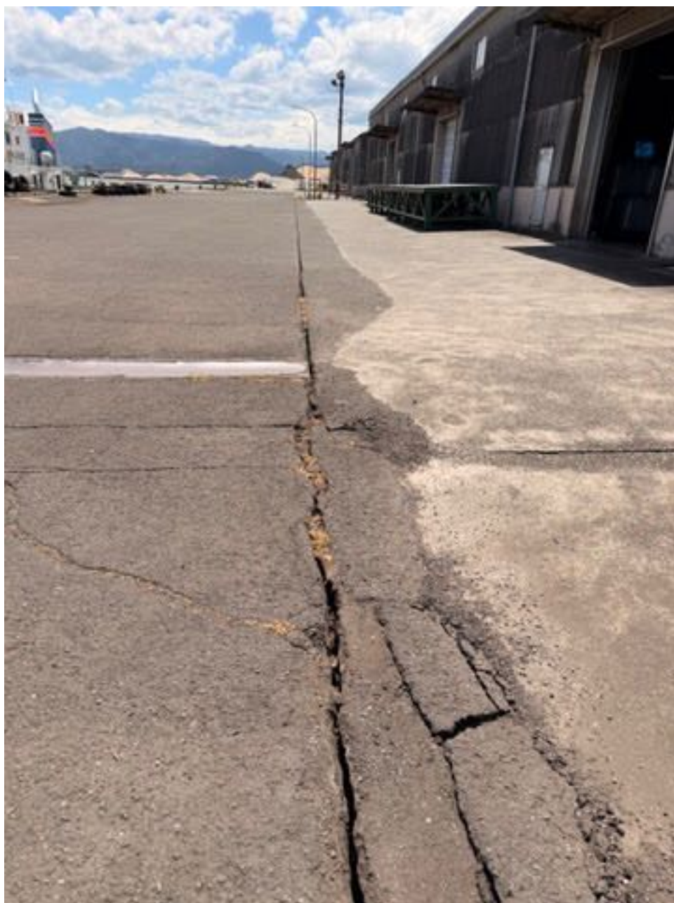
写真3. 港の作業場にひび割れが発生した.
