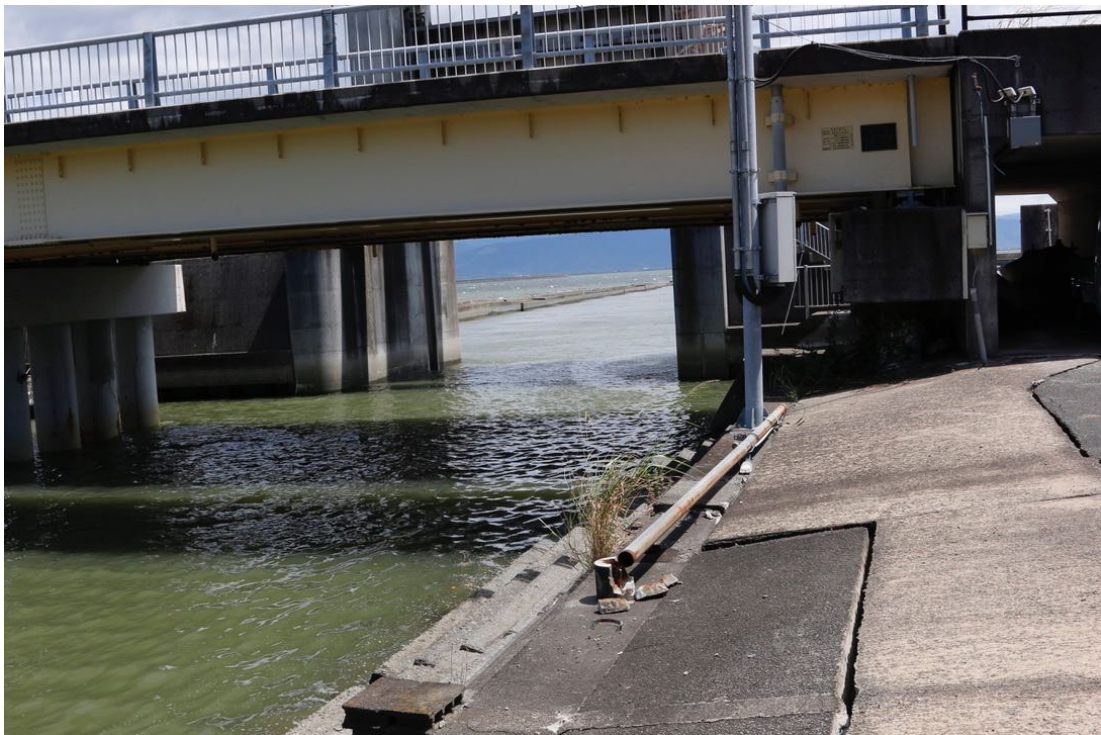
写真 2 2. 港の道路にひび割れが発生し、電柱が倒れている。
