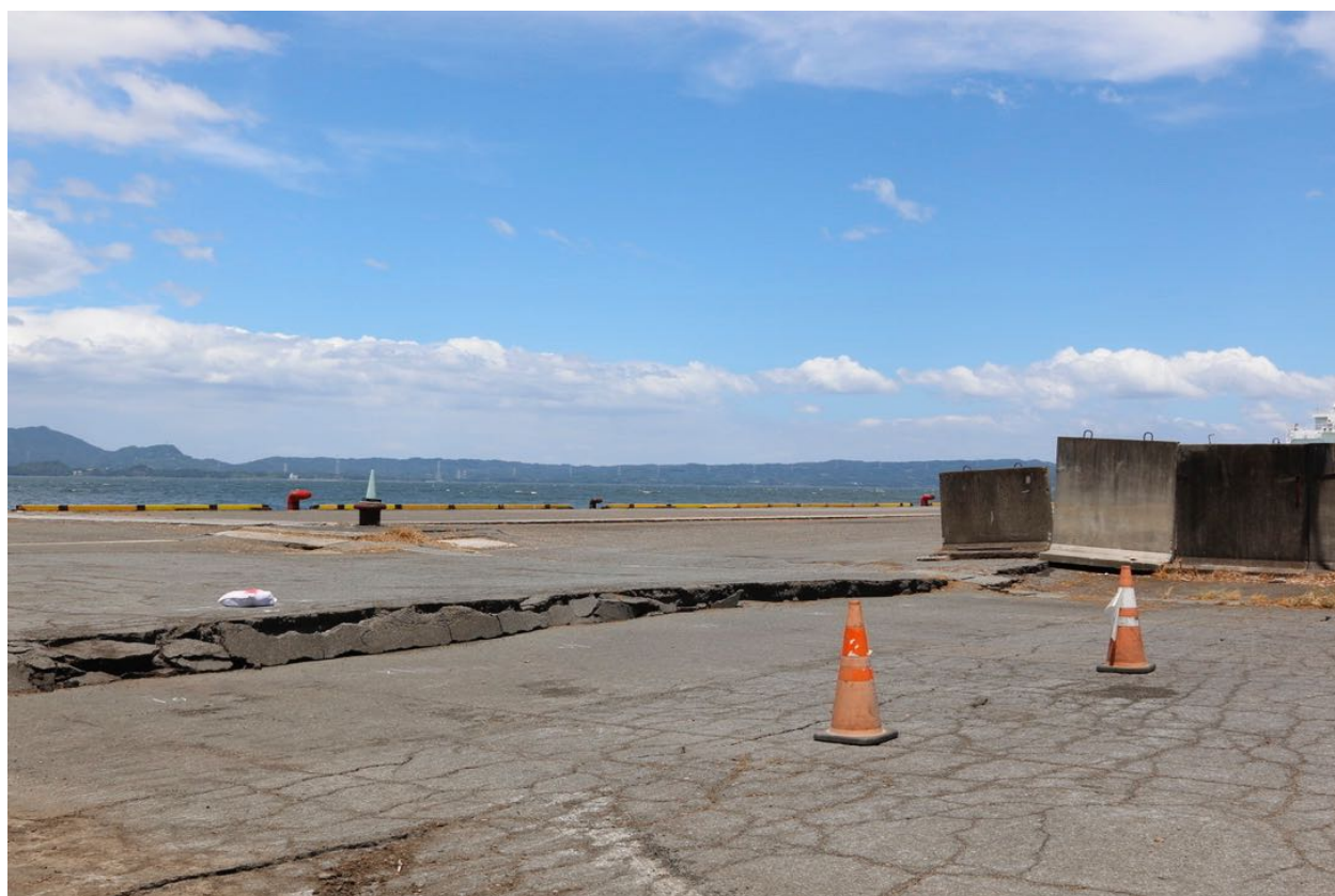
写真 1 6. 港の作業場に隆起・沈下が発生した。
