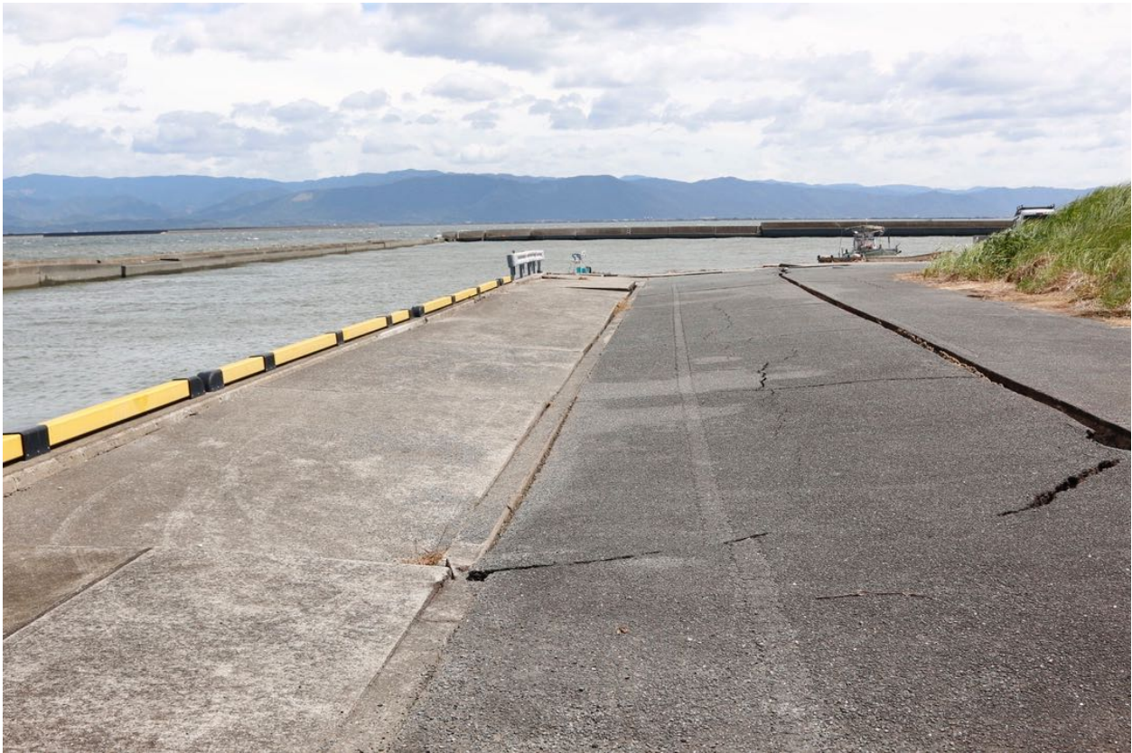
写真 2 4. 港の作業場にひび割れと変形が発生した。
