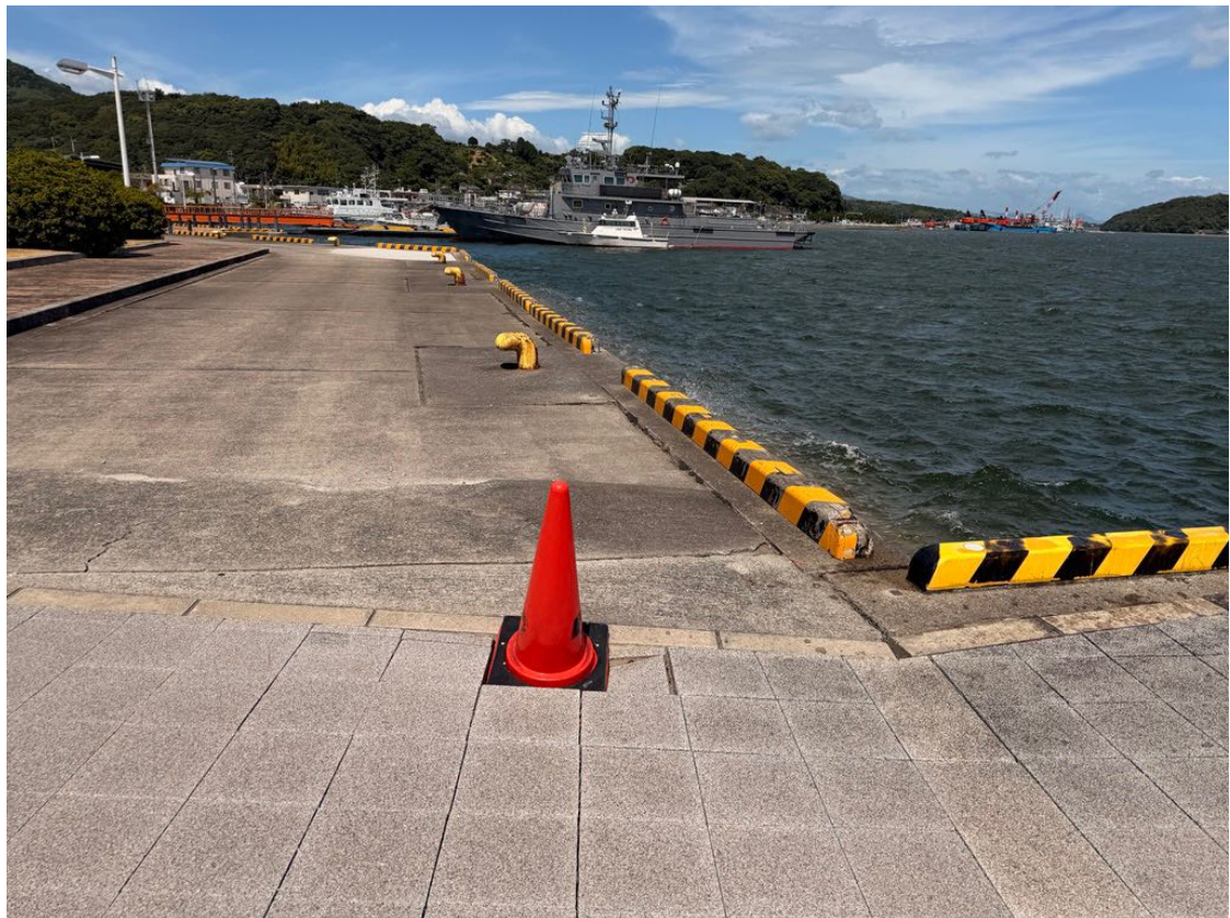
写真２７．港のブロック周辺にひび割れ、岸壁と作業場の間に変形が発生した。
