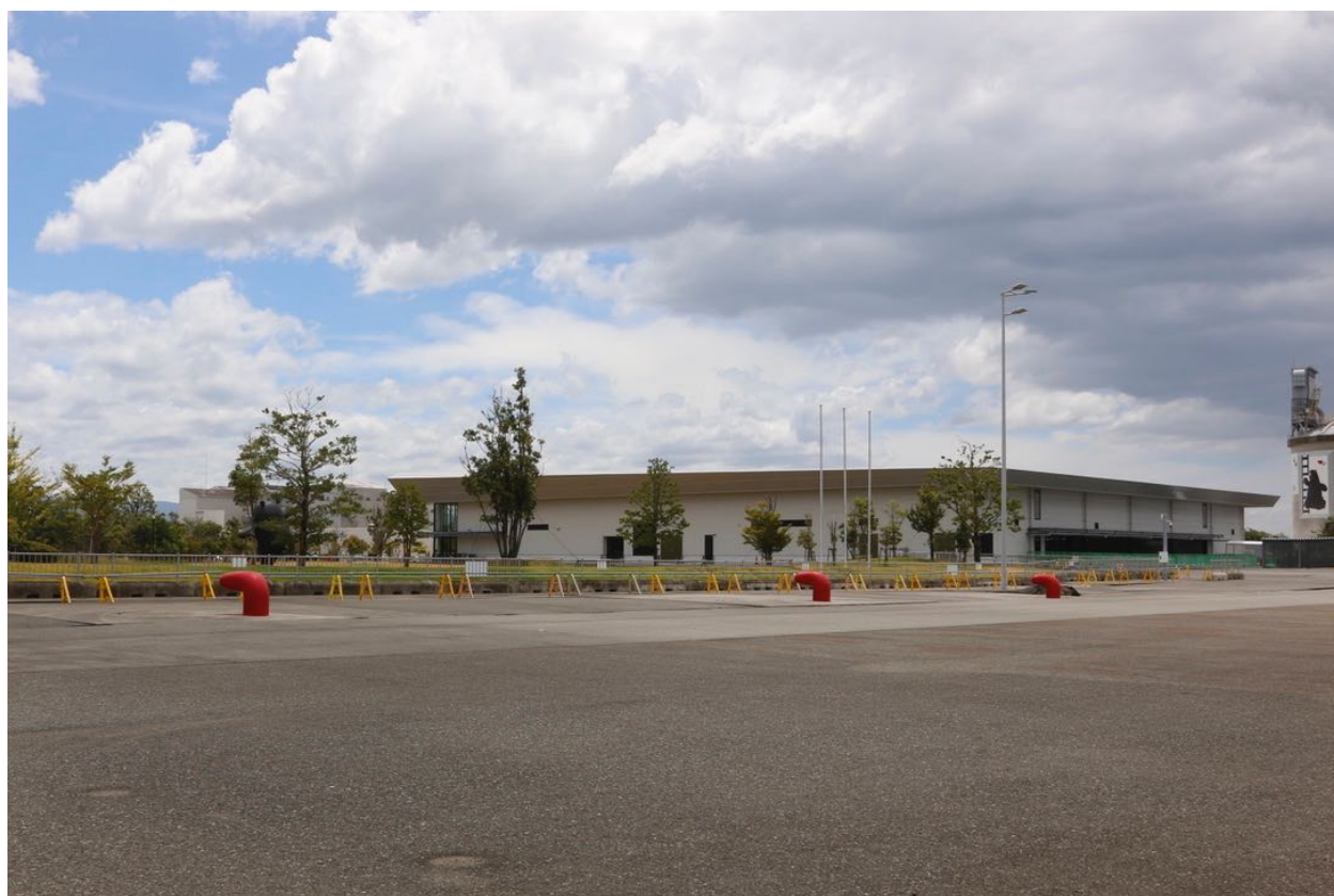
写真 1 2. 旅客ターミナルに隆起・沈下が発生した.
