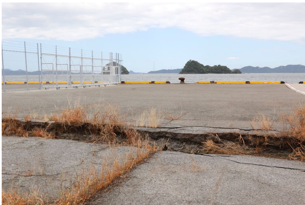
写真 1 1. 港の作業場に隆起・沈下が発生した.
