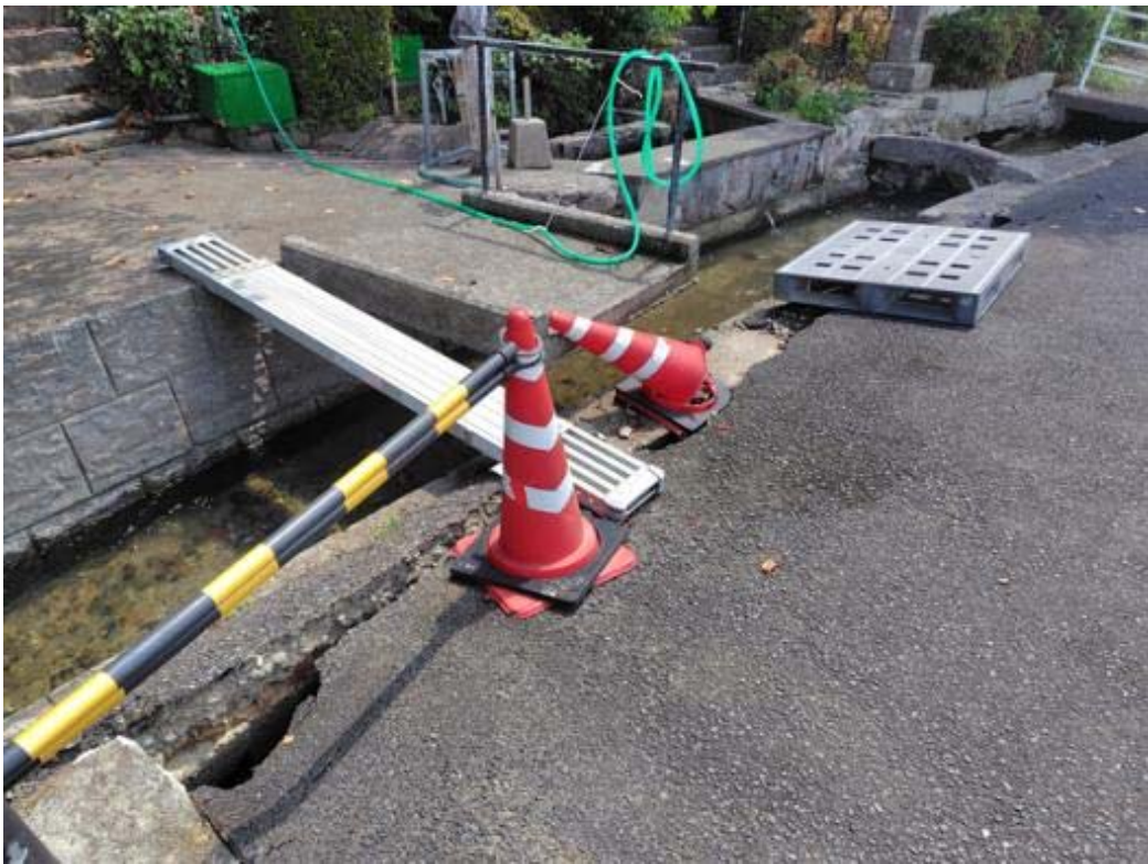
出水地蔵水源．湧水あり．この周辺は特に被害が大きい．
