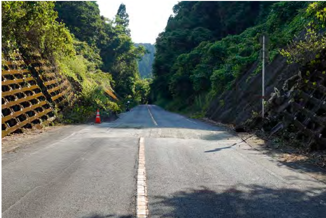
①県道244袋婆神（さばがみ）峠付近での断層による右横ずれ、南側（写真左）法面は道路面の破壊に連続せず、西側に大きく離れた位置で破壊している
