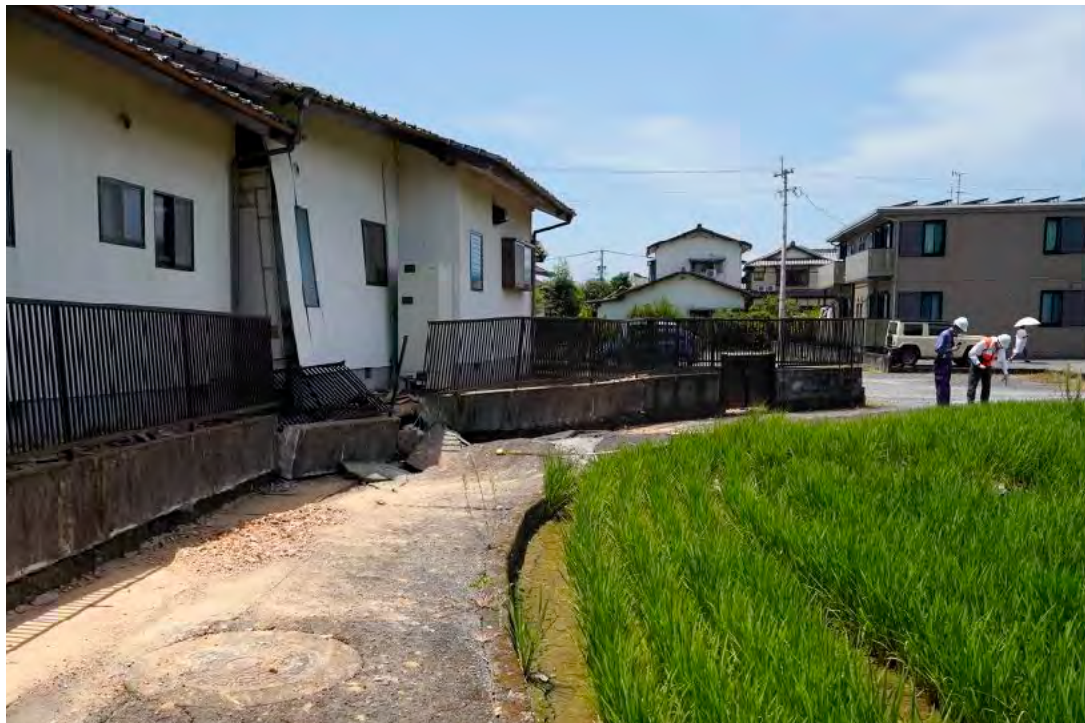
断層は右横ずれ変位により建物と道路を変形させ、水田へとつづく
