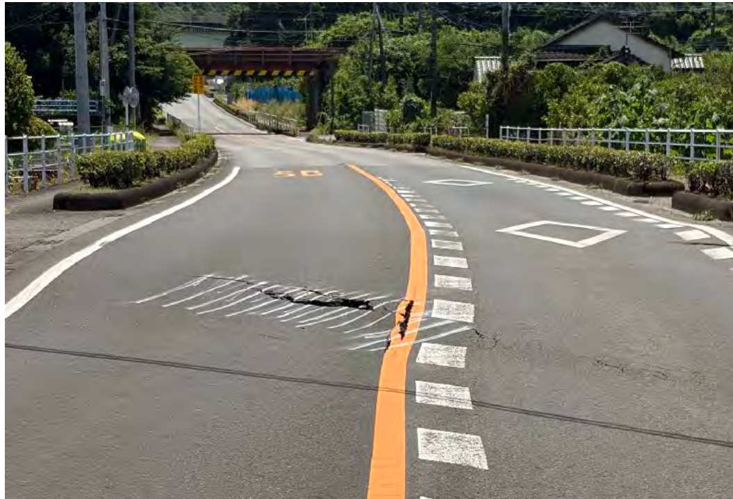
①国道219号線での断層
