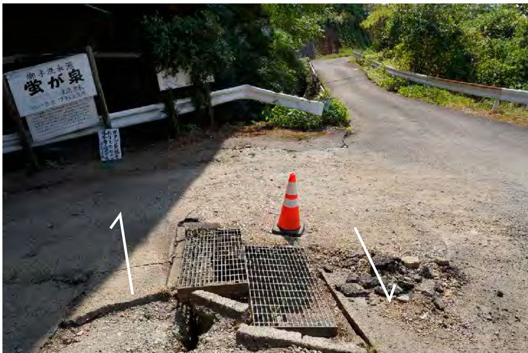
③九州自動車道陸橋下の御手洗水源、水路の右横ずれに伴いグレーチングがずれる
