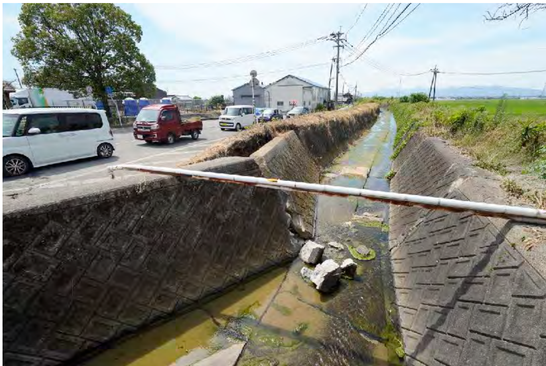
③道の駅竜北横の用水路では、断層により護岸擁壁が損傷している
