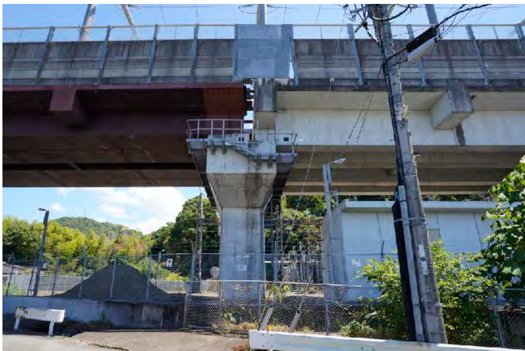
③②の南側の九州新幹線高架橋。ずれた橋桁の隙間にレールが見える、写真奥はJR九州新八代ATP
