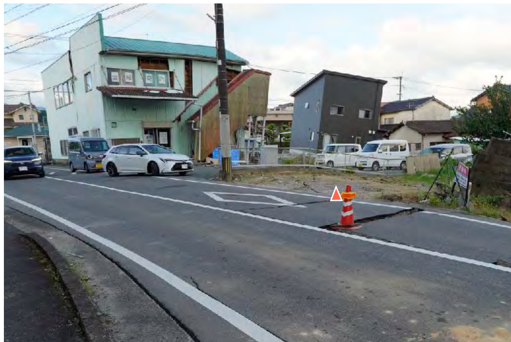
③撓曲変形が見られ、写真奥では建物が傾動している。
