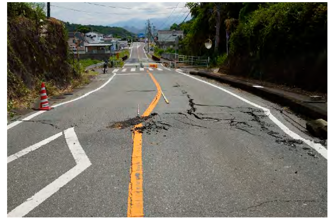
④国道218号。断層によりセンターラインが右横ずれする。写真奥に新山崎橋が見える
