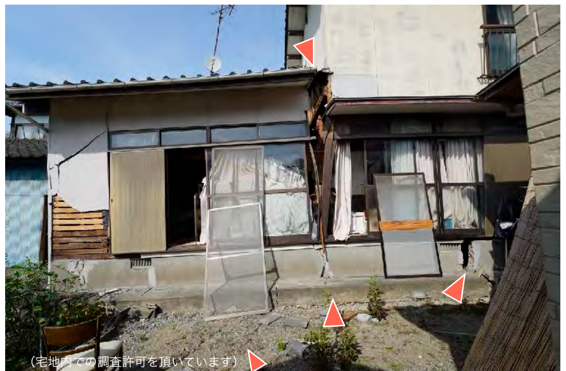
(宅地内での調査許可を頂いています) ④③の家屋の裏側の様子。断層により基礎が破壊されており，建物も裂け，沈降方向へ傾いている。
