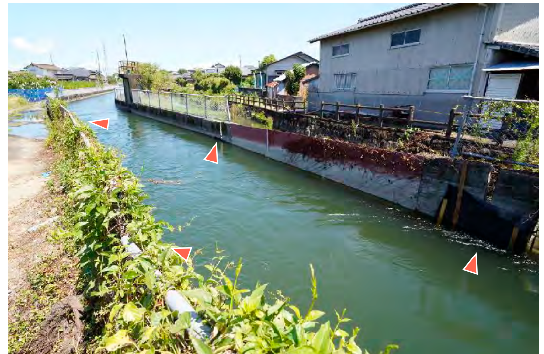
④断層により破損した用水路。亀裂から漏水する
