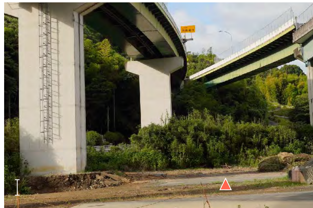
③断層は雁行しながら自動車道下を通過しているが、写真左の下り線に影響を与えた断層は△の位置付近で変位が終わるようである。橋脚の手前側が沈降している
