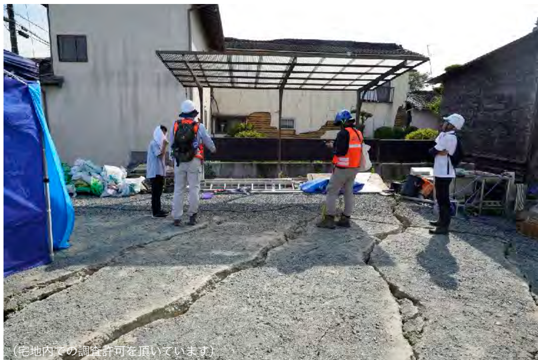
(宅地内での調査許可を頂いています) ③駐車場に現われた断層，断層は写真奥の建物の下を通過しており，建物の壁にひび割れと剥離が生じている。
