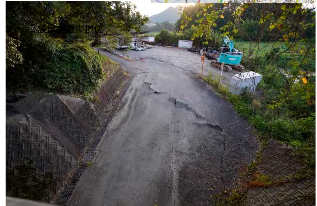
② ①の橋の上から撮影、路面の亀裂は地表地震断層ではなく、近傍での断層運動に伴う、地山と盛土との境界での変形の可能性がある。
