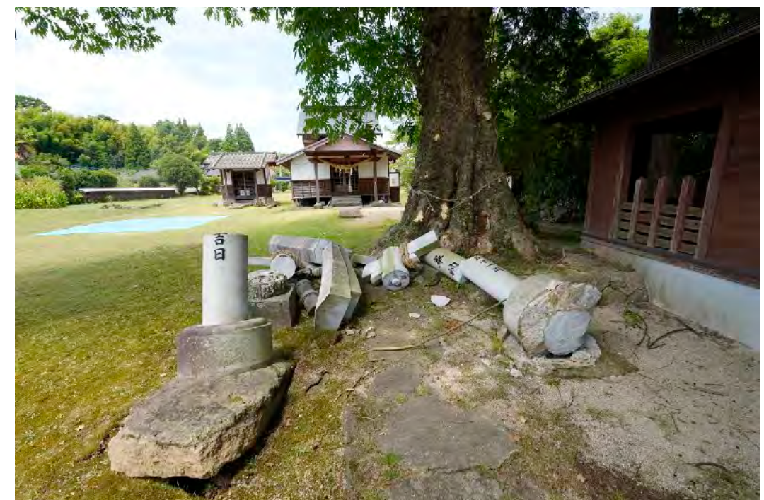
④石灯笼や令和3年に建てられた鳥居が倒れるが、社殿はかろうじて倒壊を免れている
