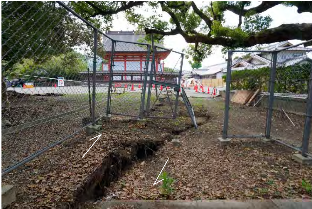
①八代神社（妙見宮）の境内を横切る断層。断層変位によりフェンスの扉が引きちぎられる。断層は本殿をかすめる
