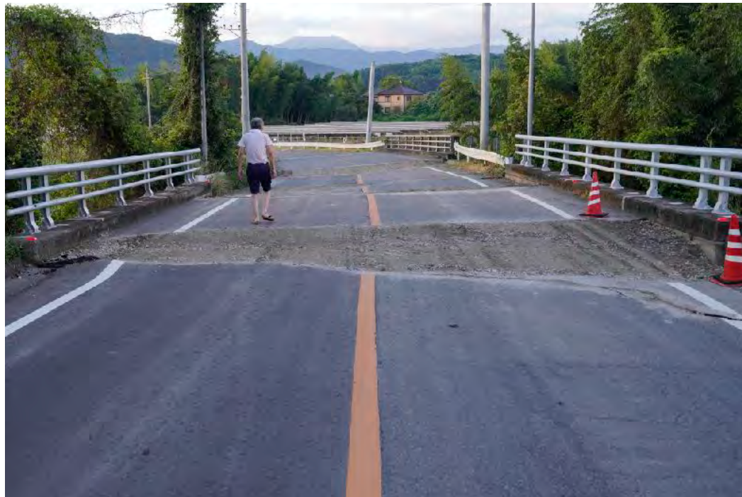
①破損した陸橋。断層は電柱の立っている橋台付近を通過していると推測される
