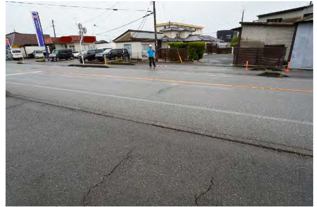
②①の断層の延長は平山新町交差点付近で国道3号線を横断する
