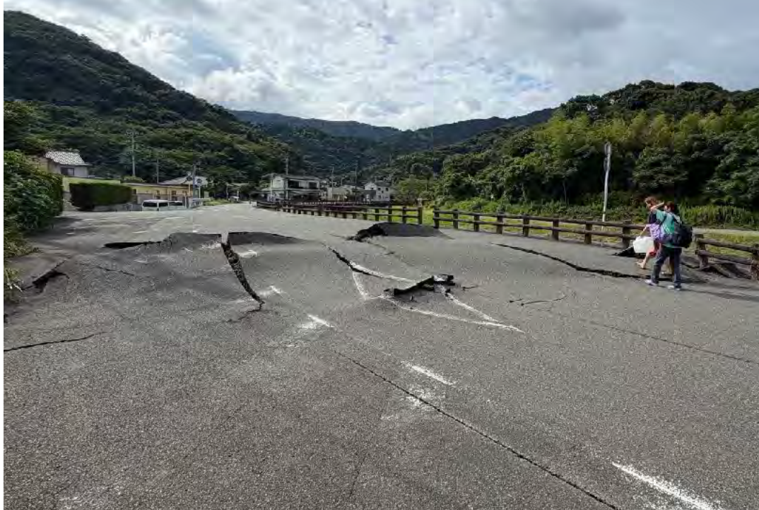
①県道155号線では断層によりアスファルトがめくれ上がる。車による通行が困難なため、歩いて湧水地まで向かう住民
