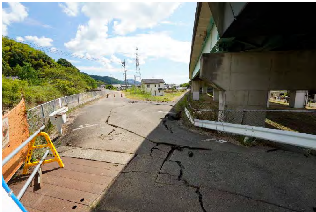
③川田橋南側側道の断層、橋下への連続性は不明瞭
