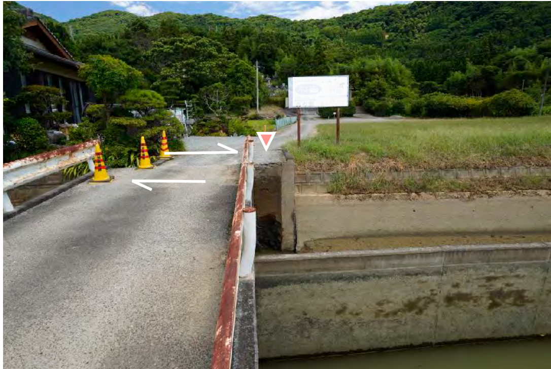
①新川にかかる橋の橋桁がおよそ90cm右横ずれする
