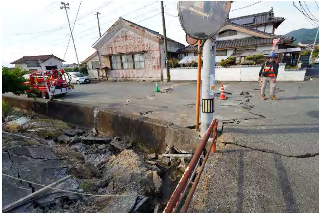
①守山八幡宮前での右横ずれ変位。水路が大きく破損する
