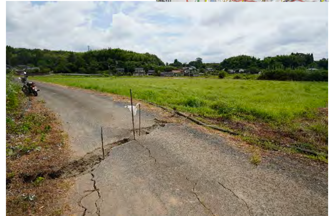
②農道を横切る断層は右横ずれし開口する。
