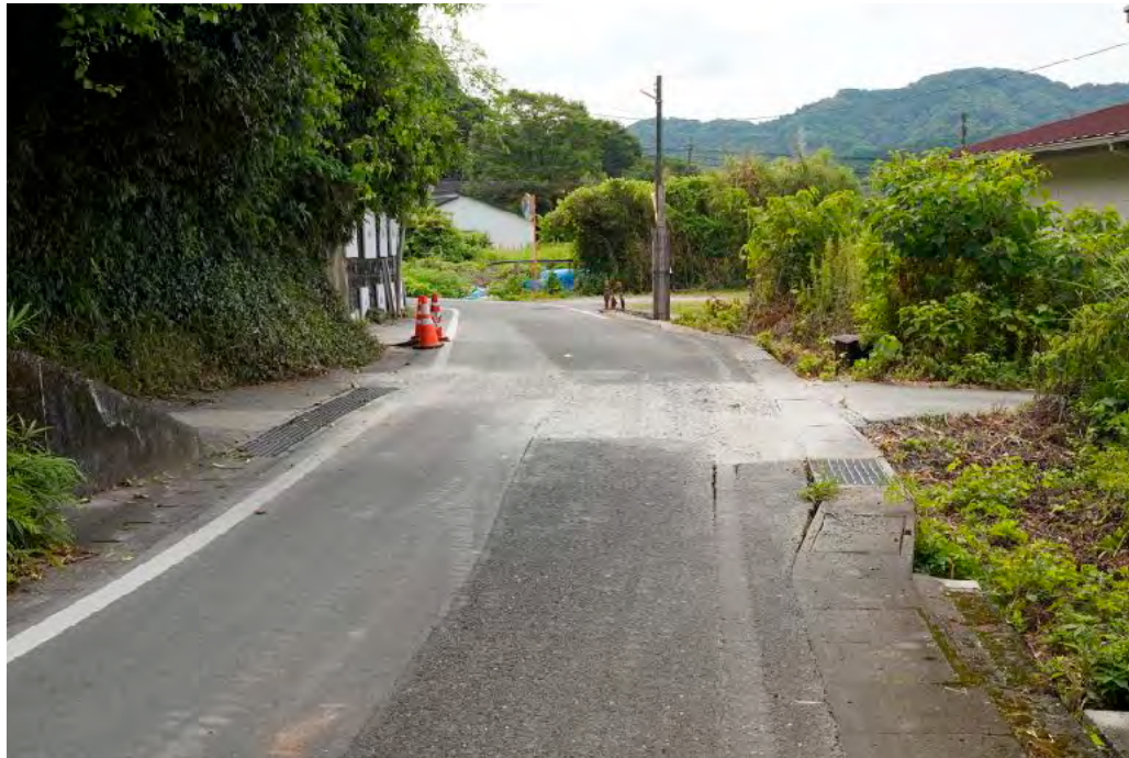
①簡易補修された断層による亀裂わずかに右横ずれする
