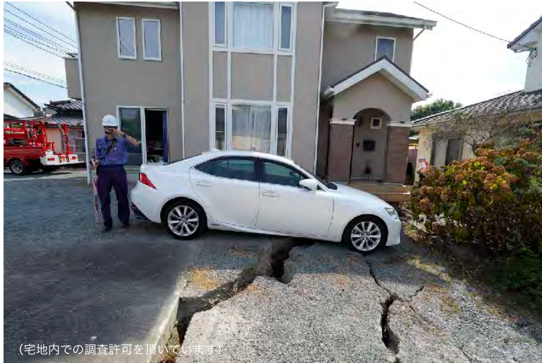
(宅地内での調査許可を頂いています) ①住宅の駐車場に現われた断層，断層は写真右側の玄関付近を通過している
