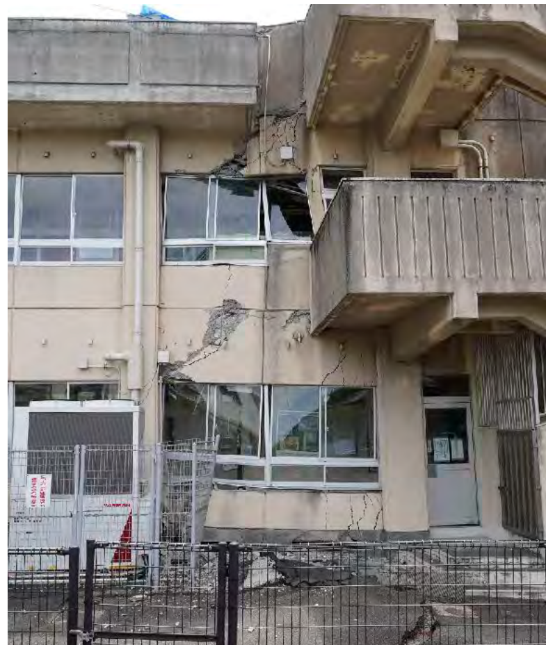
断層上での校舎の破損状況
