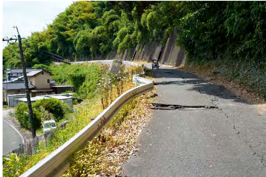
①山崎付近では小熊野川左岸の崖沿いに多数の断層が認められる。支柱間の短縮によりガードレールに変形が見られる
