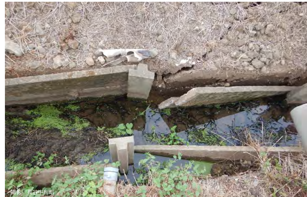
④嘉島町井寺集落～九州自動車道嘉島JCTの農道脇の水路に見られる破壊
