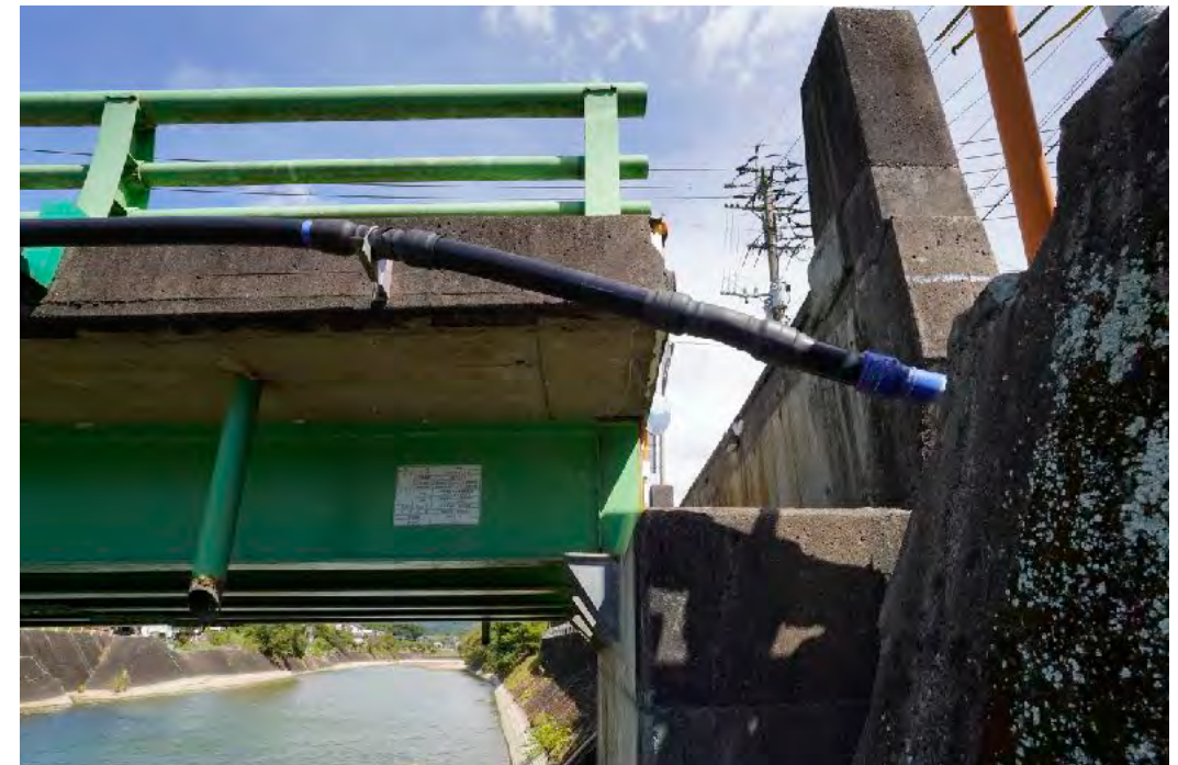
④ 左岸側の橋台にかろうじて引っ掛かる苧萱橋の橋桁。橋梁を横切る断層の変位によるダメージは妙見ジャンクションと同様
