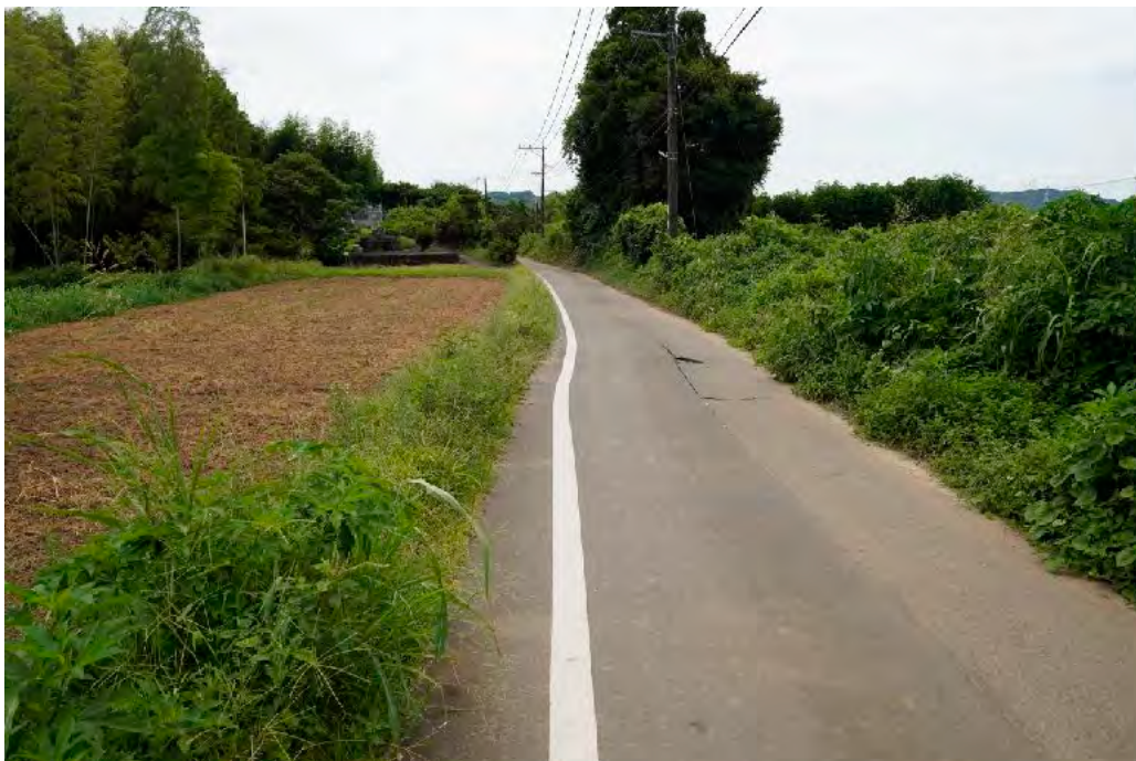
③断層は畑から道路につづき、道路白線が右横ずれを示す
