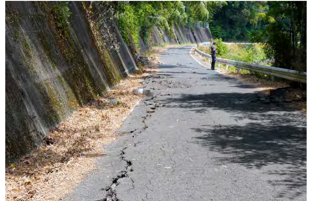
②①より南へ約200mの道路（東経塚・部田線）の亀裂の状況。地表地震断層とノンテクトニックと考えられる亀裂が混在する。急傾斜地形であり、斜面が著しく不安定になっていると考えられる。
