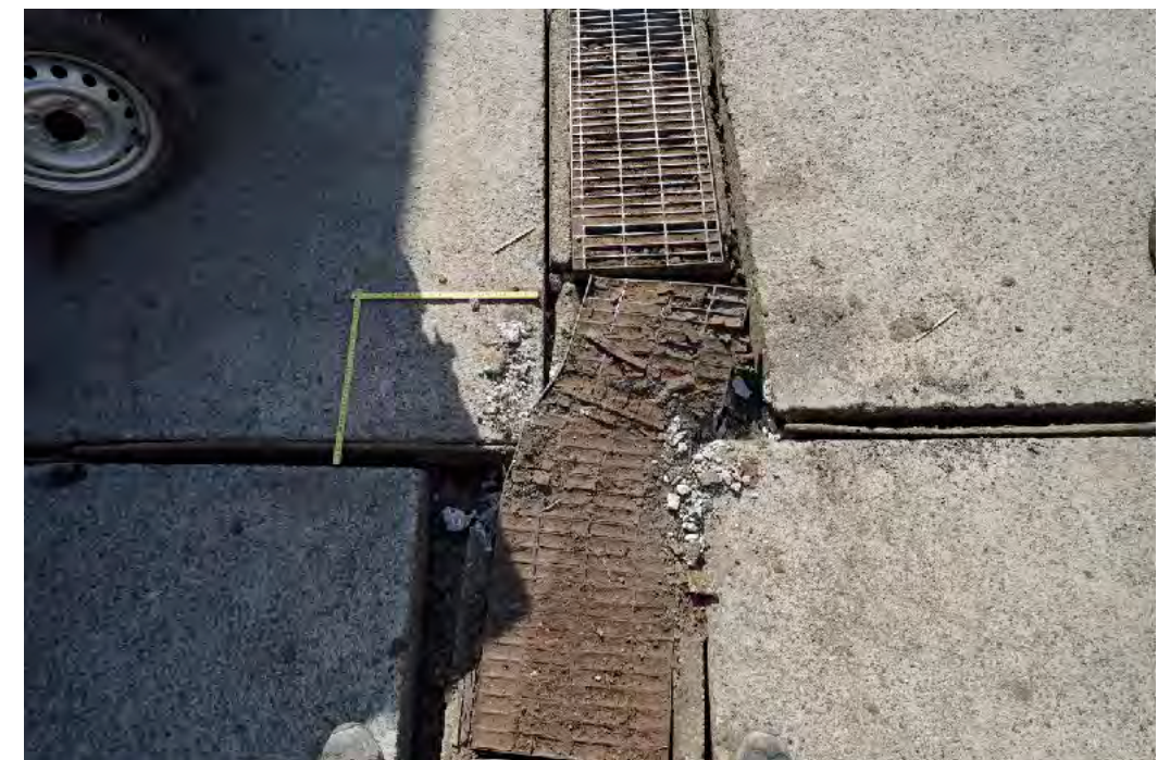
④断層によりコンクリート床が引きずられグレーチングが変形する
