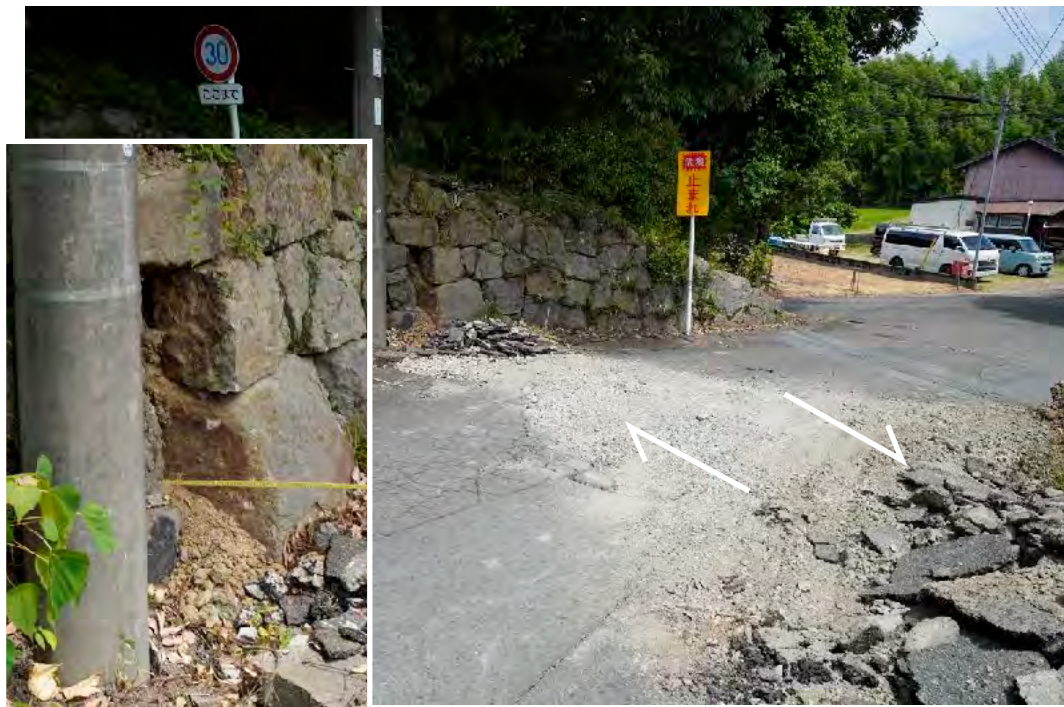
③浄水寺跡の石積み擁壁下部が断層により引きずられ変形する
