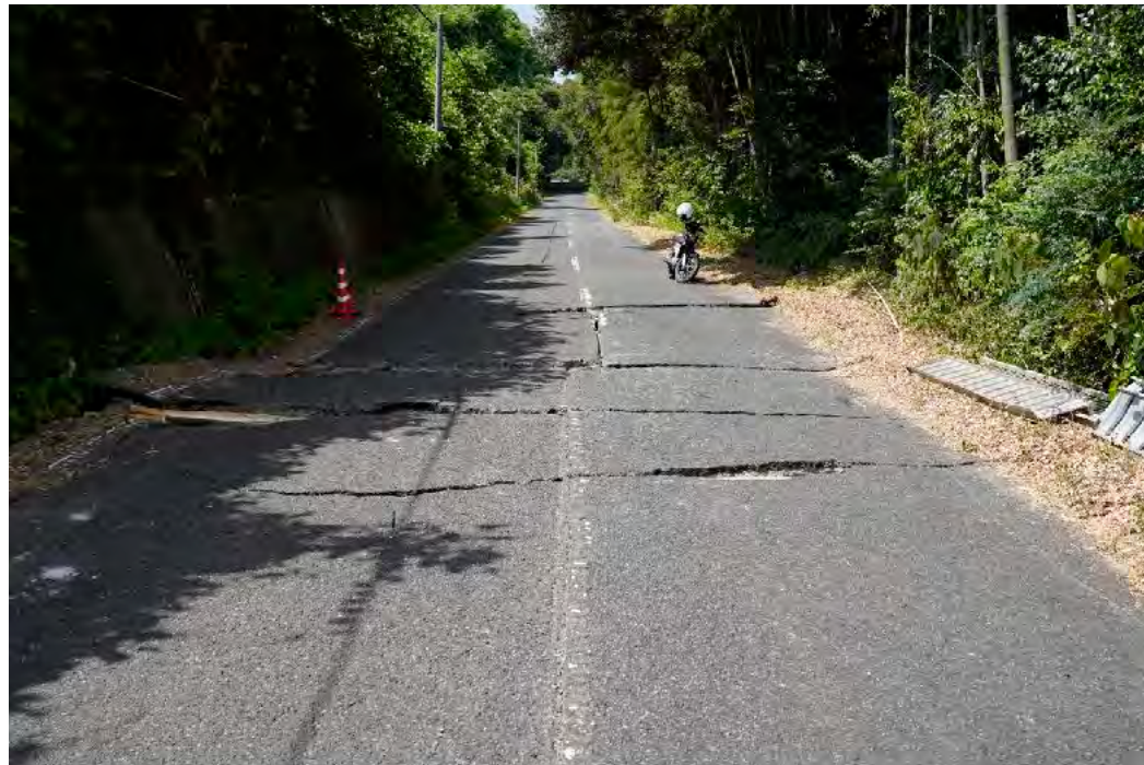
①道路（寺村古賀線）の亀裂。4条の亀裂により左右にそれぞれ変位するが全体では右横ずれに変位する
