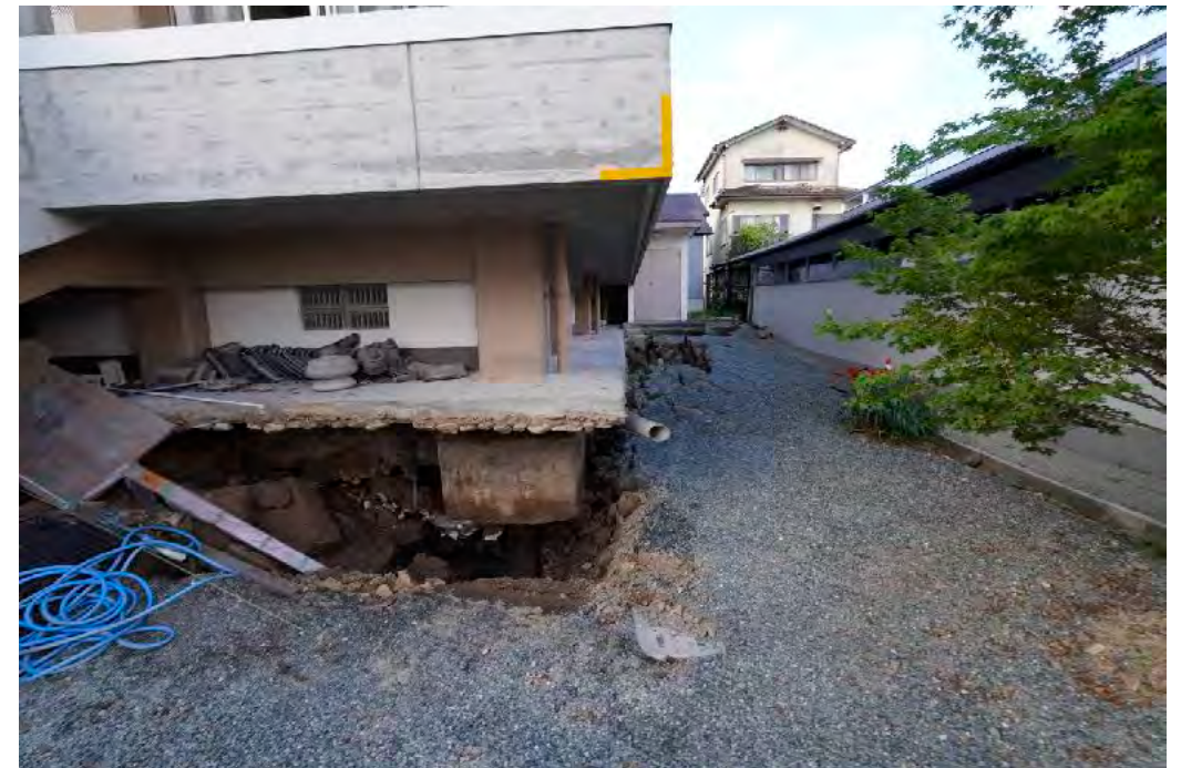
② 延福寺の本堂は断層上に位置しており、断層の沈降側では基礎が浮き上がっている
