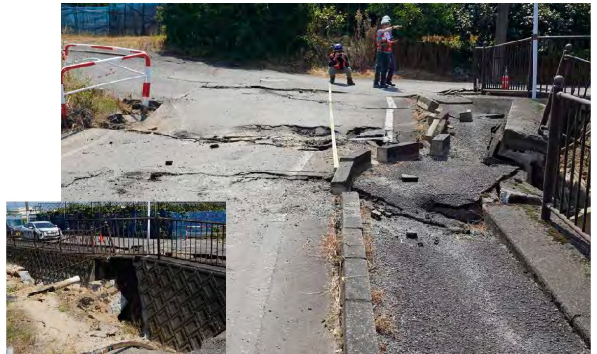
④断層変位により道路の破損状況。路面だけではなく、擁壁にも大きな損傷を与えている
