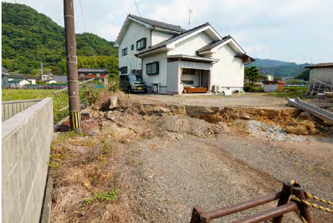
①建物の前のスペースに現われた断層。断層崖には盛土と砂礫層？がみられる。遠望では建物に外観上の大きな損傷は確認できない。
