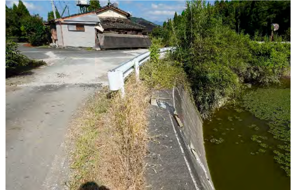
②護岸擁壁の損傷
