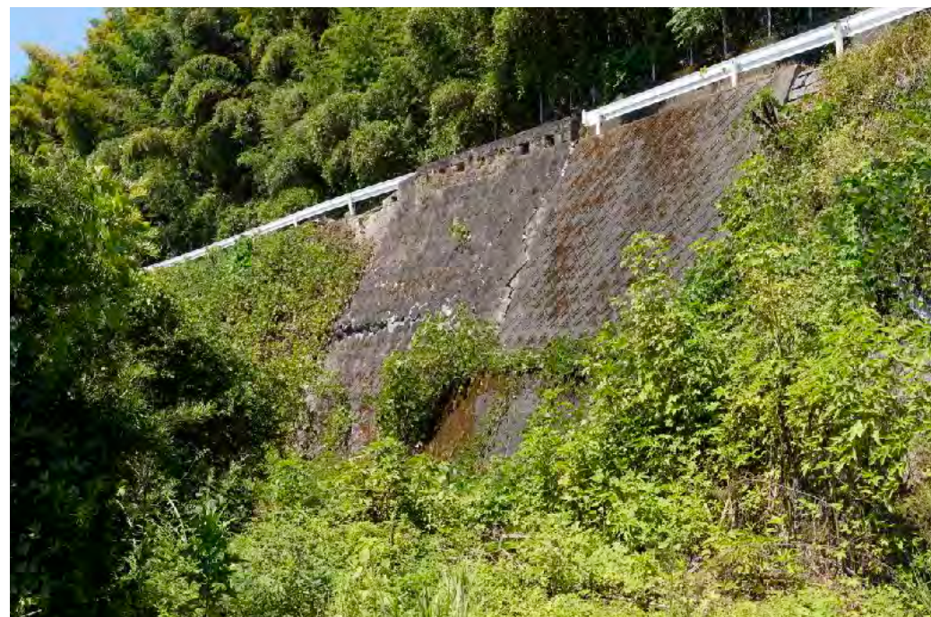
③擁壁の破損が多数見られる
