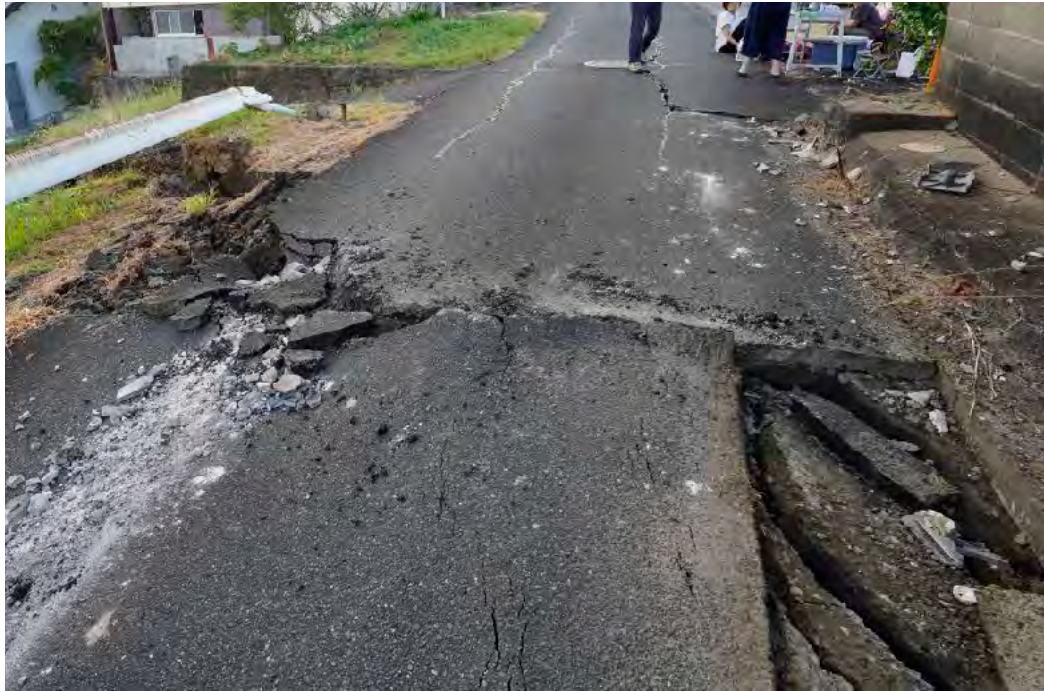
① 右横ずれする道路（砂川右岸線）。断層近隣の家屋からは住民が屋外避難している
