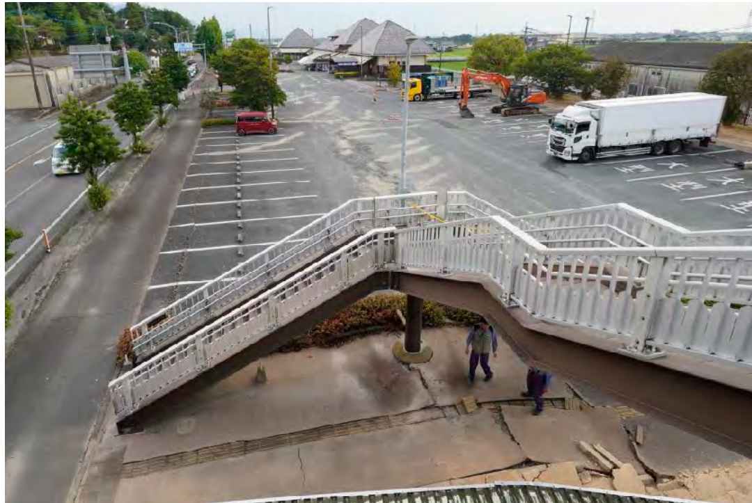
①国道3号線（写真左）と平行するように道の駅竜北の駐車場から歩道橋の下まで杉型雁行亀裂が確認される
