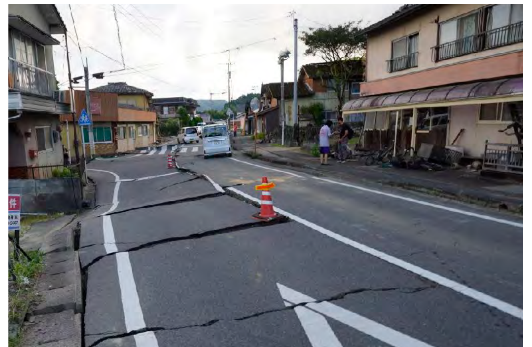
④③での電柱付近からの撮影。道路（益南・小川線）のアスファルトは地下の断層変位に引きずられ複雑に変形する
