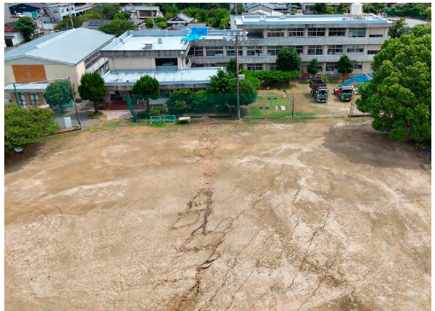
龍峯小学校に現われた地震断層。断層は校庭から校舎下へ続く
