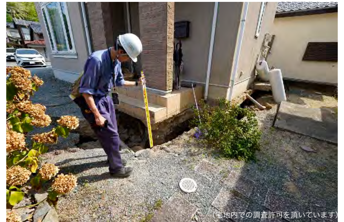
(宅地内での調査許可を頂いています) ②①宅の玄関付近の様子。断層による変位で建物が約50cm浮いた状態になっている。プロパンガスボンベが散乱するもホースは接続状態で保たれていた
