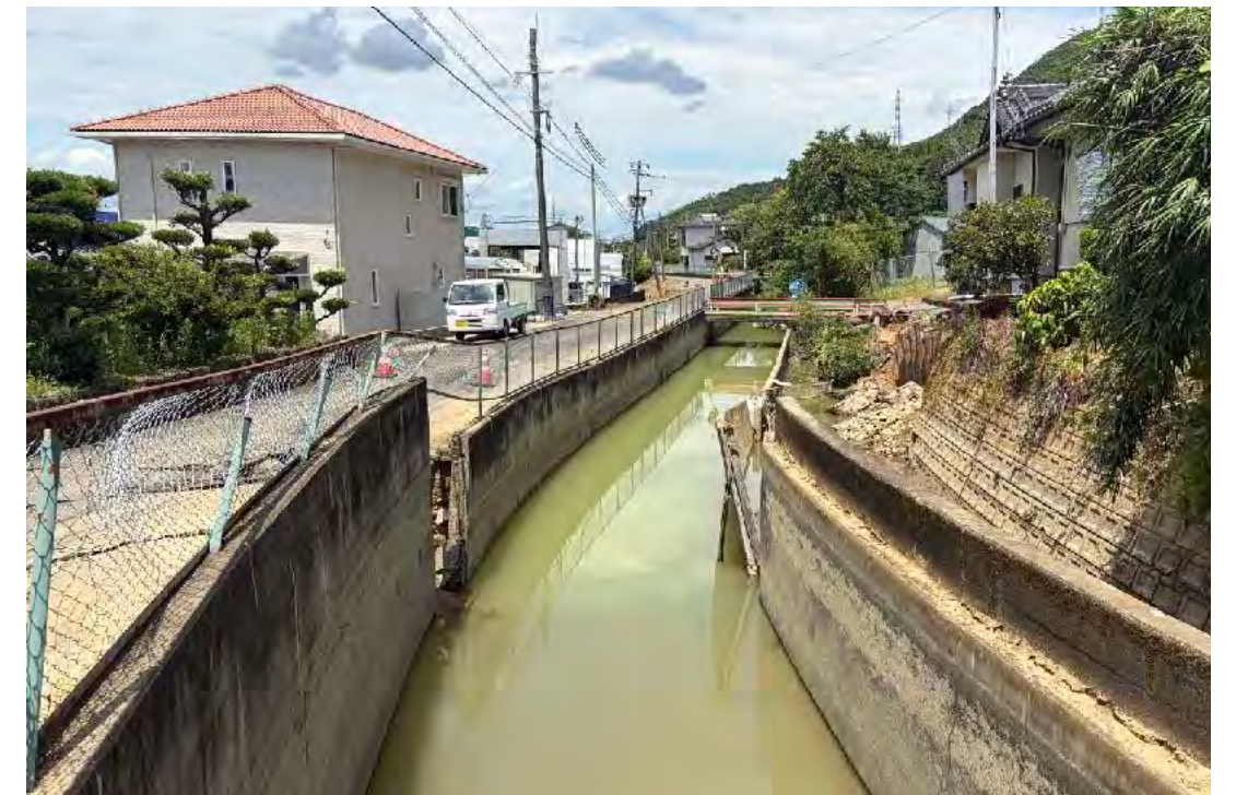
④③地点での新川護岸の破損状況
