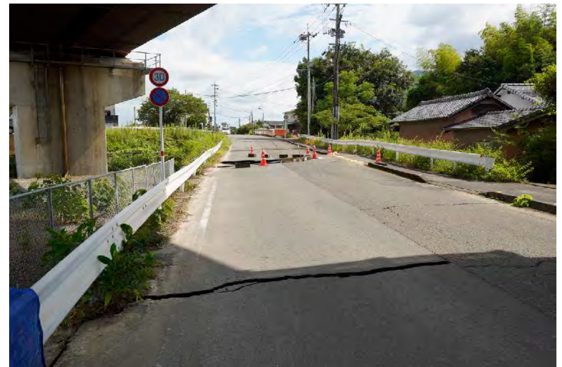
②県道158号線を横切る断層。高架橋はJR九州新幹線
