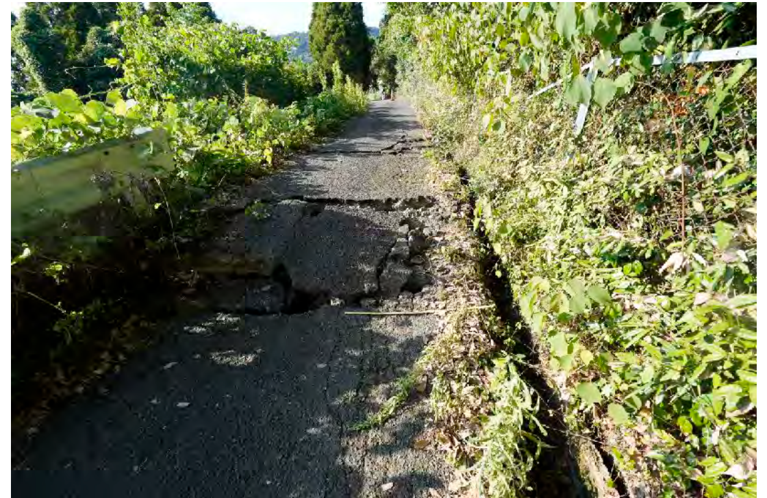
②九州自動車道の側道に現われた断層
