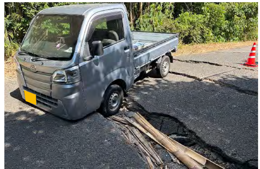
②①の亀裂はおよそ50cm開口しているところもあり、通過を試みた軽トラが亀裂に落下し動けなくなる
