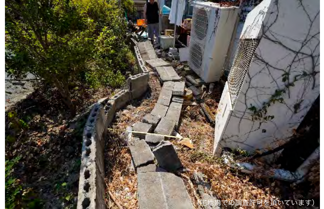
①右横ずれ変位によりブロック塀が変形し倒壊する
