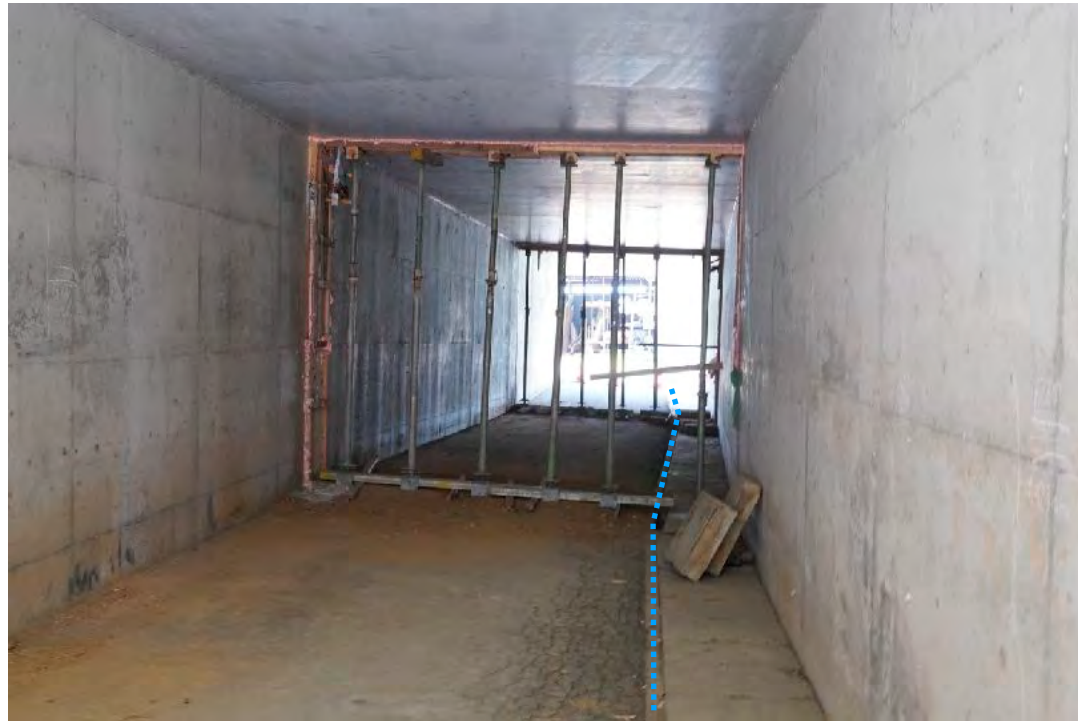
①九州自動車道下のカルバート（松橋19）が右側に変形する
