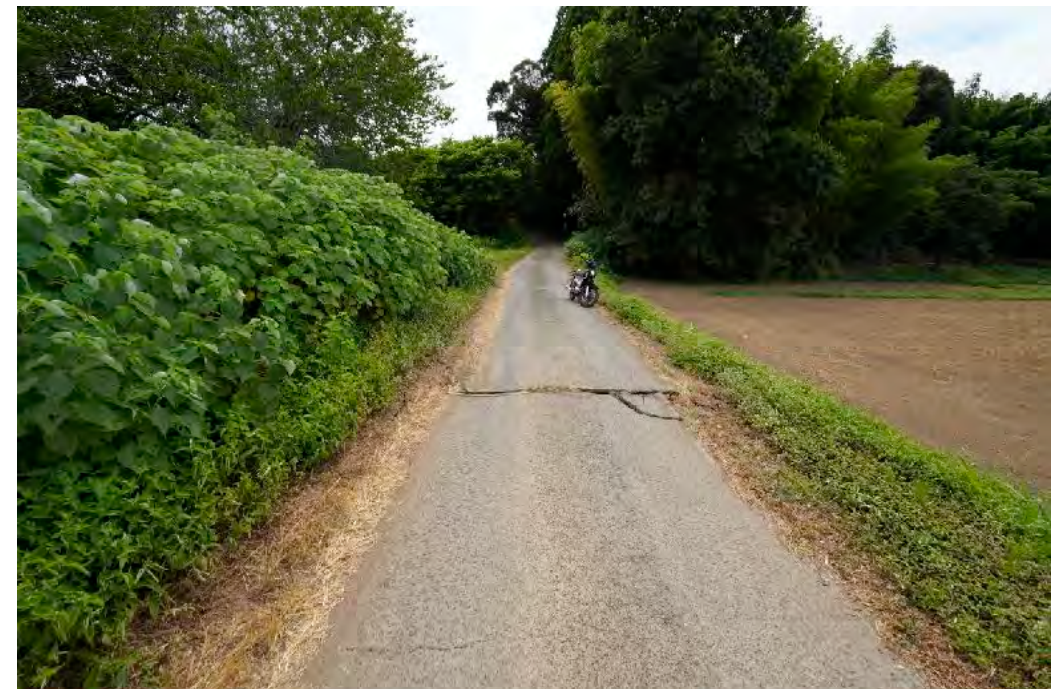
④ここでも畑から道路に断層がつながる。鰐瀬付近では明瞭な右横ずれ変位するが、垂直変位はわずかである
