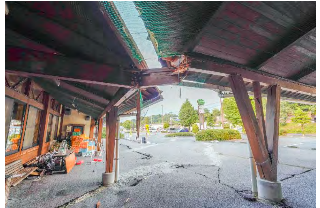
②道の駅の建屋では、建屋下を通過する断層により梁が破断するなど建屋が変形している
