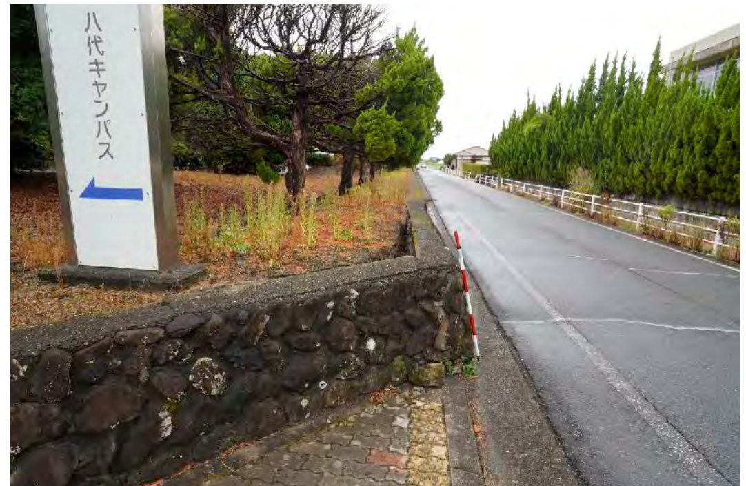
④③の断層の南西側延長部では道路に多数の亀裂や、擁壁の変形が見られる
