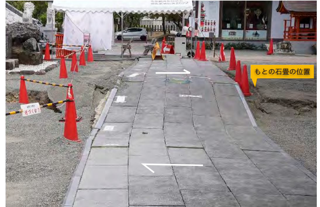
②断層による縦方向の変位で石畳の参道が坂道となった。また、この石畳は右方向へも変形しているが、地面とのカップリングが弱かったため、右横ずれする地面の移動に完全には追従せず破壊を免れた可能性がある
