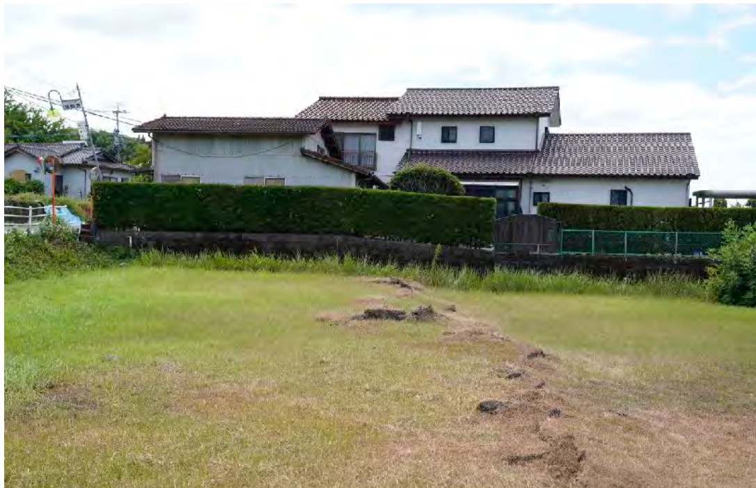
③地震断層が家屋を横切る。ブロック塀と垣根の変状が断層変位の影響を表している。外見からは建物に大きな変状は見られないが、断層直上部では大きなダメージを受けている
