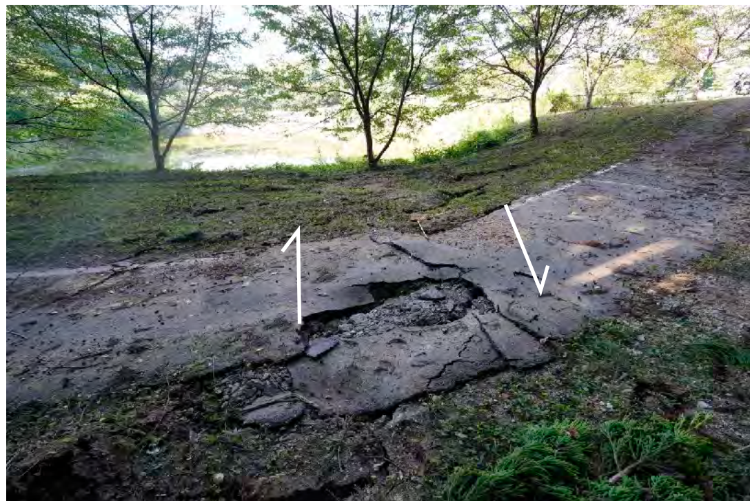
①断層により右横ずれした道路。断層はため池に続いている
