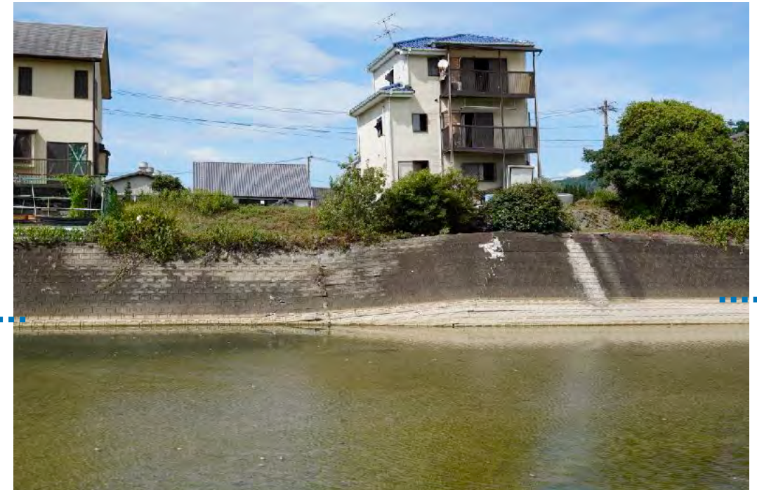
② 断層（撓曲）による砂川右岸での護岸の変形。護岸の風化による境界線と水面との関係は北西側（写真左）の沈降を示している。
