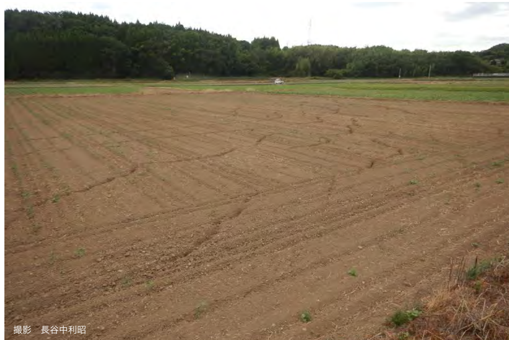
①嘉島町北甘木の東側台地に向かって畑地上を南北～北東-南西方向に伸びる亀裂群
